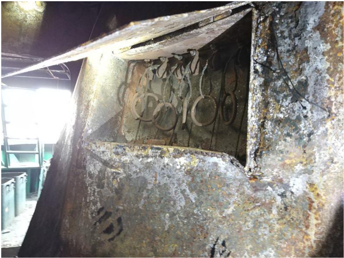
图 5 “晟通油”机舱速闭阀
