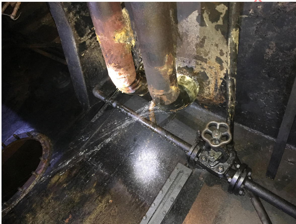
图4：“晟通油”轮机舱导热油管系压力测试下显示的渗漏处
